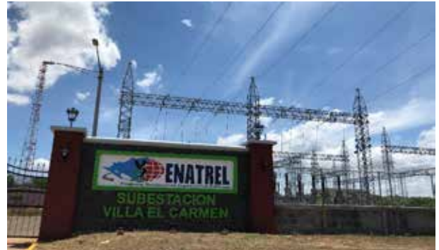
एक्विज़ बैंक ने निकारागुआ सरकार को ट्रांसमिशन लाइनों और सब-स्टेशन के निर्माण के लिए 26.24 मिलियन यूएस डॉलर की ऋण-व्यवस्था प्रदान की। Exim Bank extended a LOC of US$ 26.24 million to the Government of Nicaragua for construction of transmission lines and substation.
